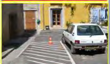
Fuite n°5 Casse sur réseau
