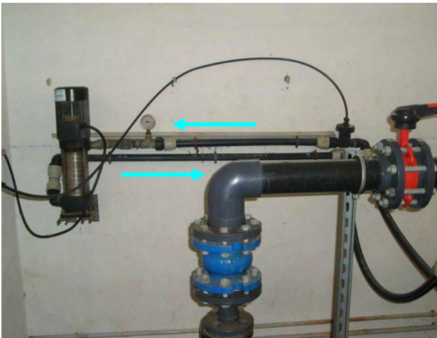
Illustration n°2 Traitement : pompe à chlore
