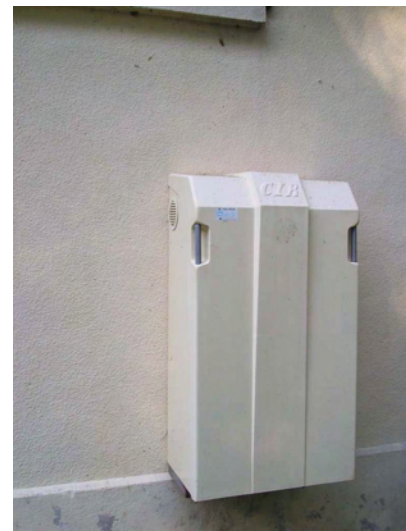
Illustration n°5 Traitement : stockage chlore
