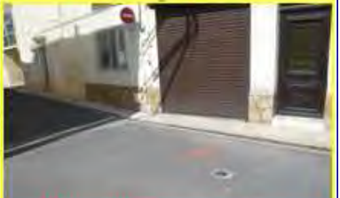
Fuite n°3 Casse sur réseau
