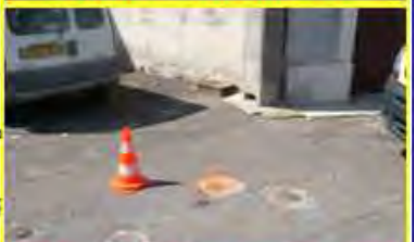
Fuite n°4 Branchement - PI
