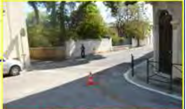
Fuite n°2 Branchement
